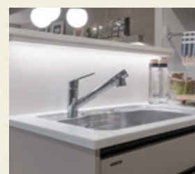
11 手元照明 手元を明るく照らす照明を設置しました。繊細な作業が必要な料理でも、安心して包丁を使うことができます。
